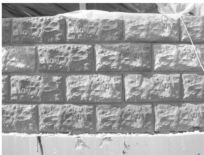
Рис. 4. Разрушение растворных швов в стене
