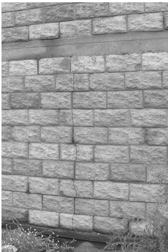
Рис. 3. Вертикальная трещина в стене из блоков
